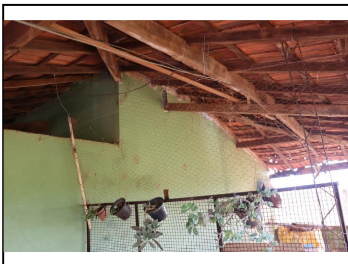
Foto 15 – Casa de caseiro – Estado de conservação ruim.
