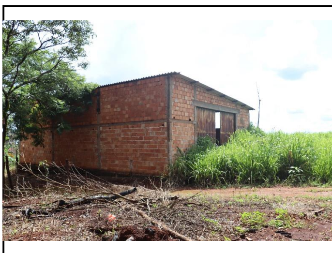
Foto 12 – Galpão - Estado de conservação ruim.
