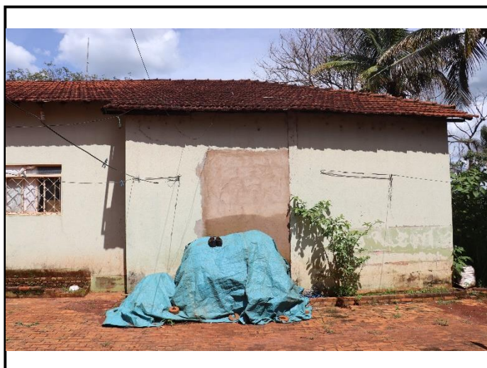
Foto 9 – Telhados antigos com vazamentos.
