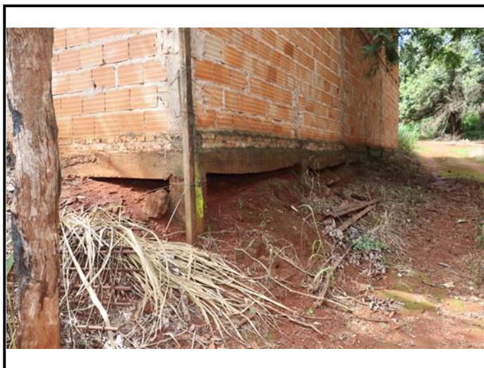
Foto 13 – Galpão – Estado de conservação ruim.
