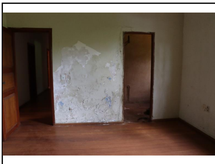
Foto 7 – Sala com infiltrações.
